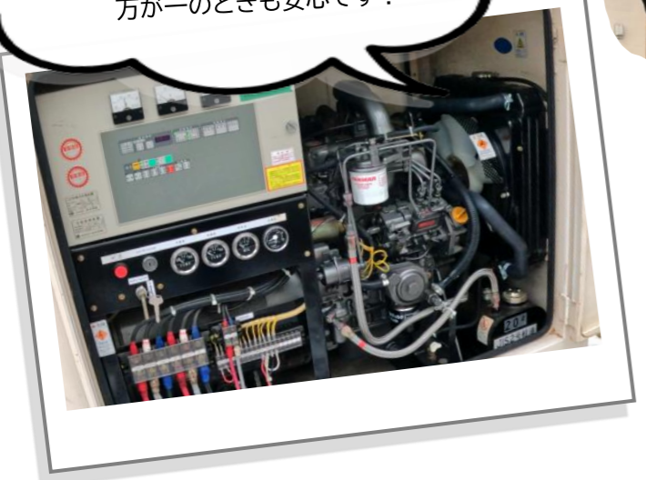
ひかり苑 助成内容：非常用自家発電設備の改修
